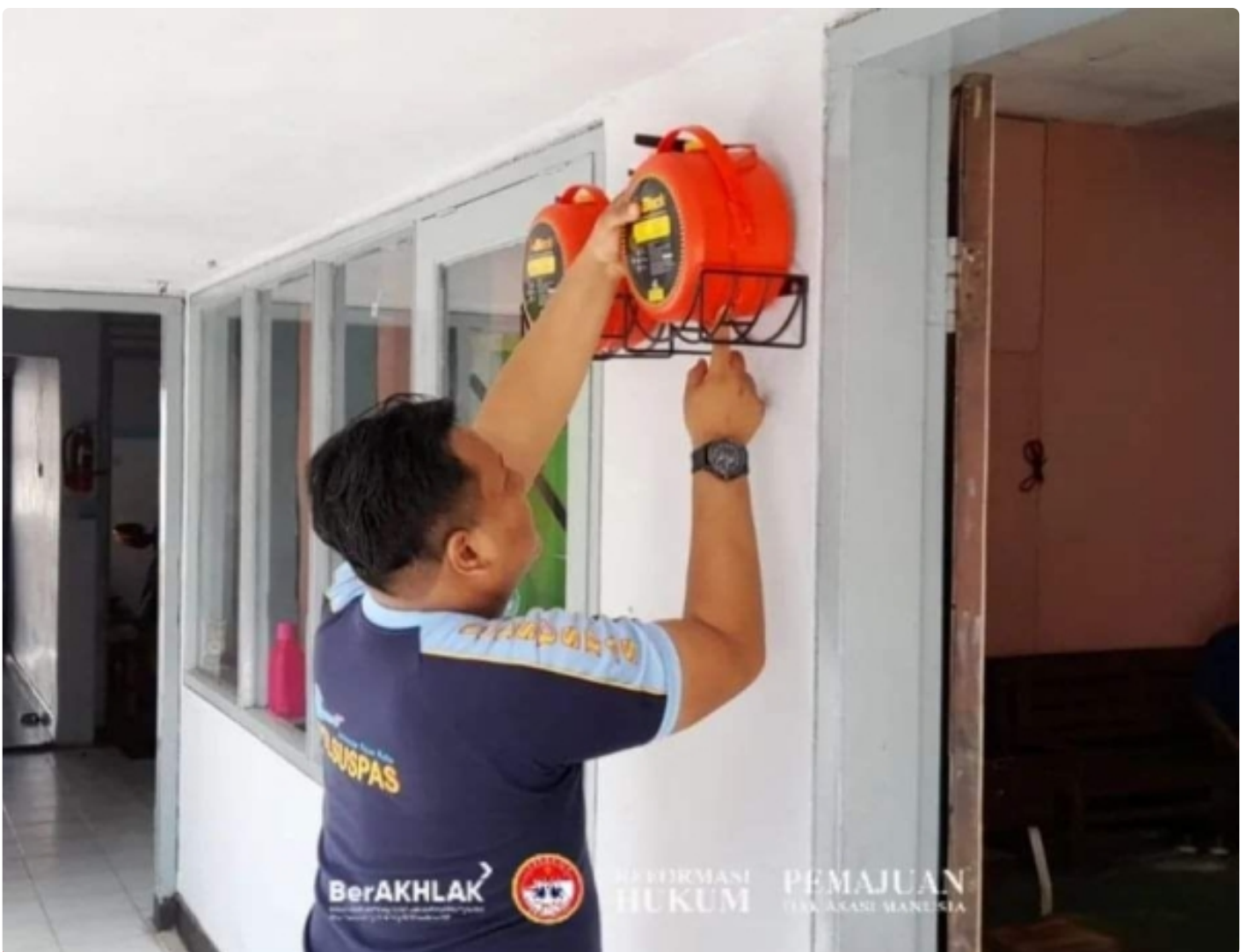
Antisipasi Kebakaran, Rutan Blora Pasang APAR di Titik Rawan
